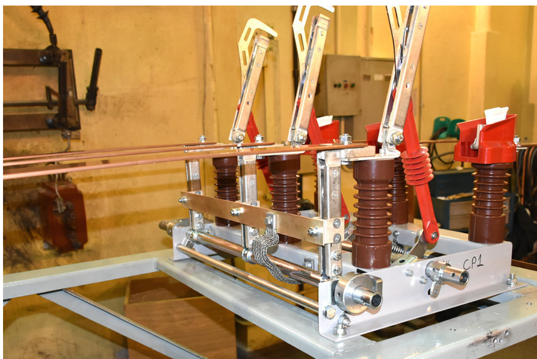
Fotografia 9: Detalhe do seccionador antes das aplicações de corrente no circuito de aterramento.
